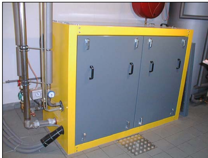
Bild 9: BHKW mit Anschlüssen
