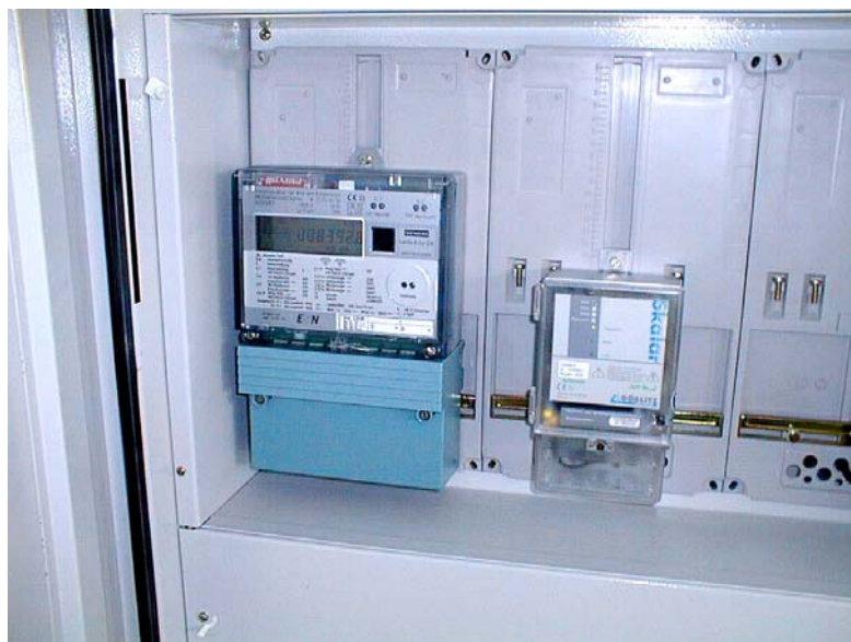
Bild 16: Stromzähler für die Einspeisung (Quelle: EVN)
