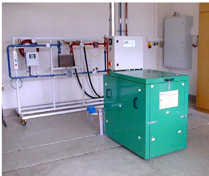
Bild 13: Prüfstand für Blockheizkraftwerke an der BLT
