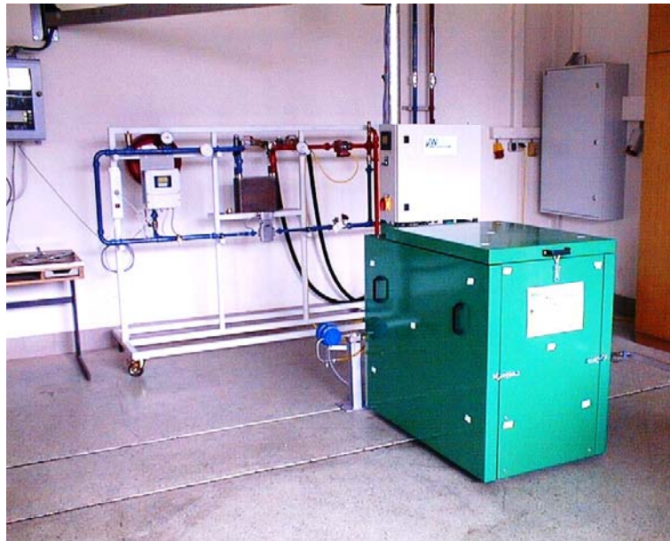
Bild 27: BHKW im Dauerlauf am Prüfstand
