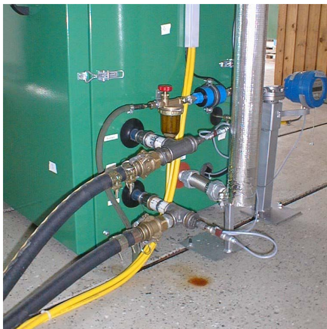
Bild 22: Anschlüsse des BHKW
