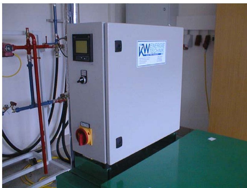
Bild 23: Anlagensteuerung und Bedienung
