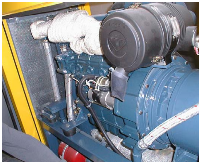
Bild 5: Motor und Generator eines Klein-BHKW
