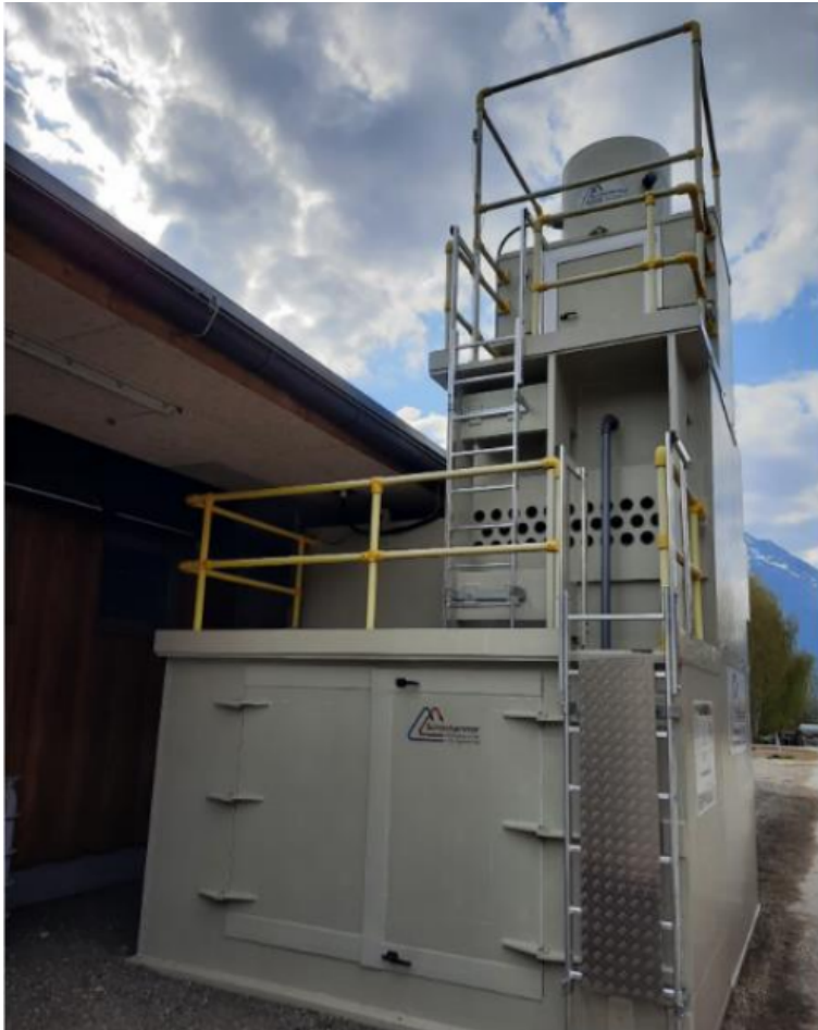
Abbildung 2 Umgebaute Tauschwäscheranlage der Firma Schönhammer am Standort Gumpenstein
