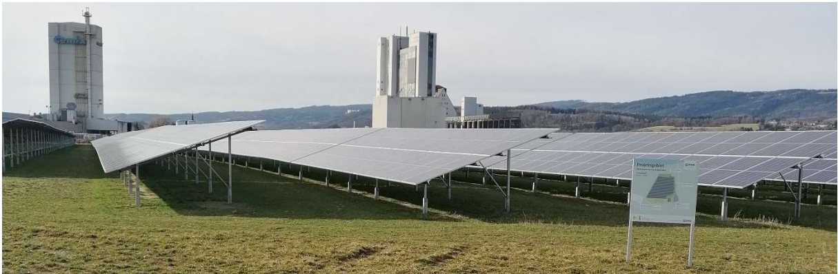
Abbildung 4: Klassische PV-Anlage mit Grünfläche (eigene Aufnahme)
