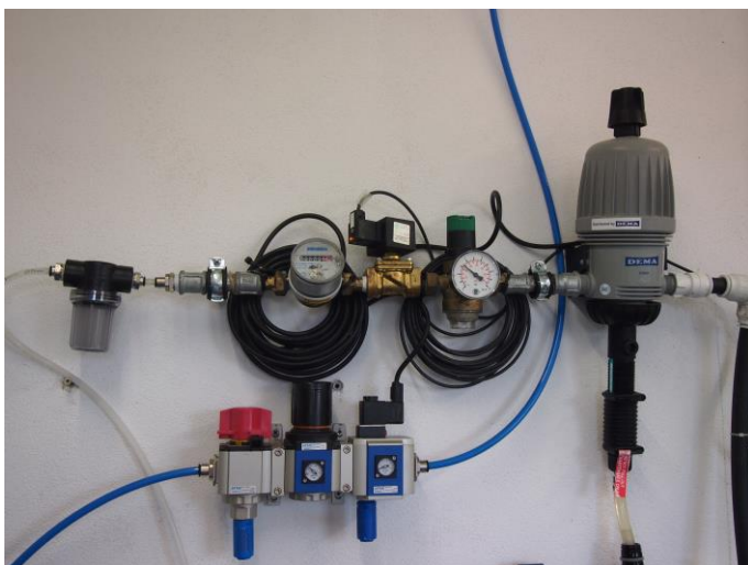
Abbildung 1: Steuer- und Regeleinheit im Technikraum
