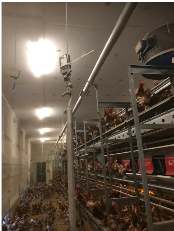
Abbildung 24: Montage des Temperatur-/Feuchtefühlers im Versuchsstall
