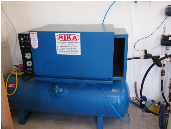
Abbildung 2: Schraubenkompressor zur Beschickung der luftgeführten Leitung
