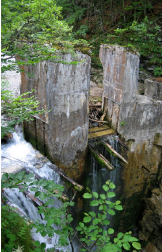
Abb. 5.11: baufällige Rettenbachklause, flussaufwärts über 10 m aufgeschüttet
